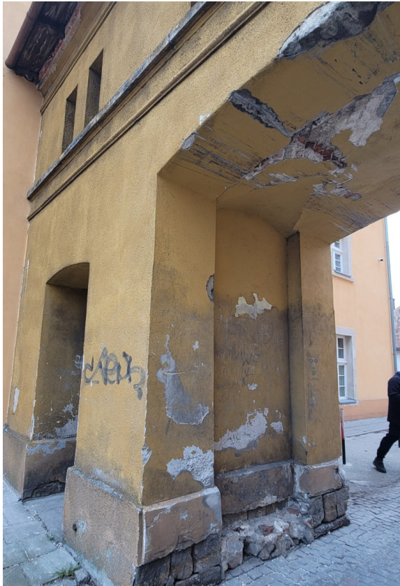
Fot. Przejazd bramowy pod łącznikiem. Widoczne ubytki tynku, zdegenerowane tynki w strefie cokołowej, ubytki tynku na sklepieniu od uszkodzeń mechanicznych od przejeżdżających pojazdów.
