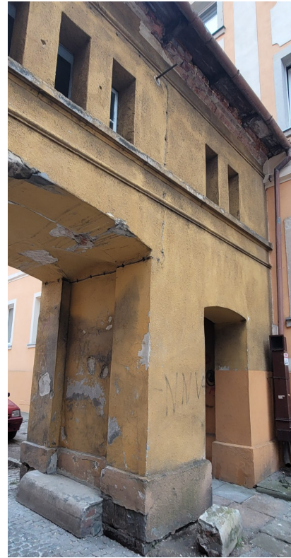
Fot. Przejazd bramowy. Widoczne uszkodzenia tynku. Odłamany fragment ceglanego odboju/krawężnika. U góry widoczne ubytki w ceglanym gzymsie
