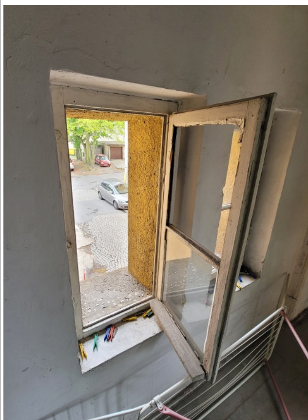
Fot. Współczesna drewniana stolarka okienna w złym stanie technicznym
