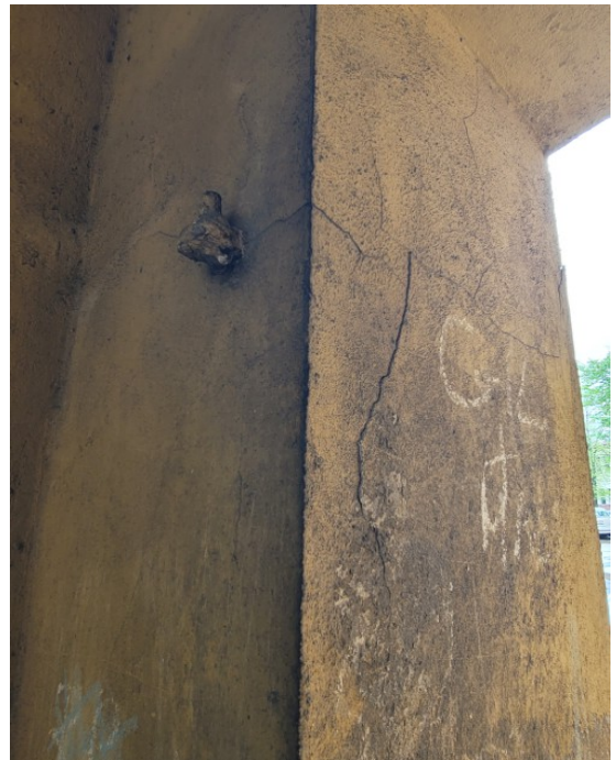
Fot. Widoczne spękania i odspojone płyty tynku pokrytego współczesnymi szpachlami i tynkiem cienkowarstwowym akrylowym
