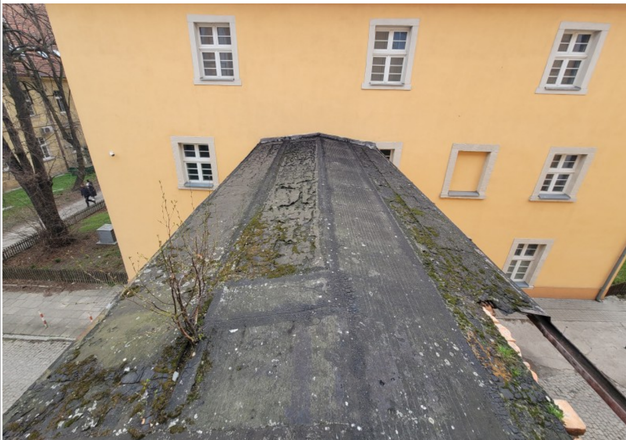
Fot. Znacznie zniszczone pokrycie dachowe, stan bardzo zły, brakujący fragment deskowania i murowanego gzymsu
