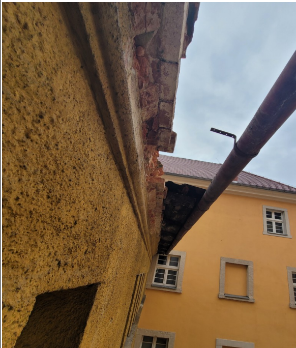
Fot. Gruboziarnista struktura współczesnego tynku "barank" na poziomie kondygnacji, widoczny uszkodzony gzyms z brakującymi fragmentami. Brak deskowania i obróbki pasa nadrynnowego. Brak końcówki krokwi.
