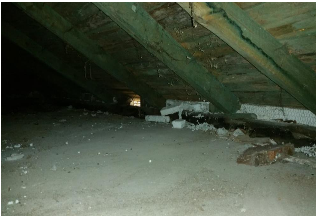
Fot Oparcie krokwi na murłacie. Widoczne zacieki na krokwi od nieszczelnego pokrycia w obrębie wierzchołka dachu.
